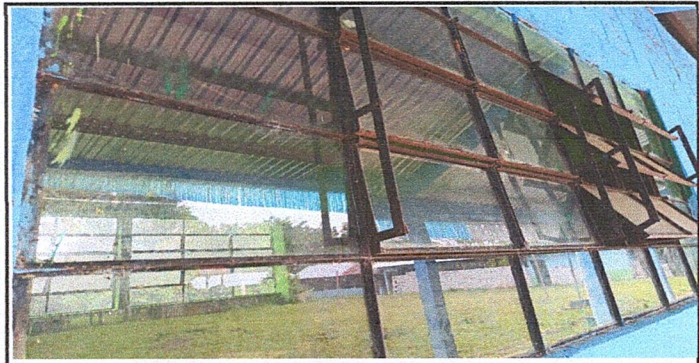
Foto1: Ventanería del centro educativo en mal estado, no se pueden abrir todas las ventanas correctamente. Mala ventilación.
