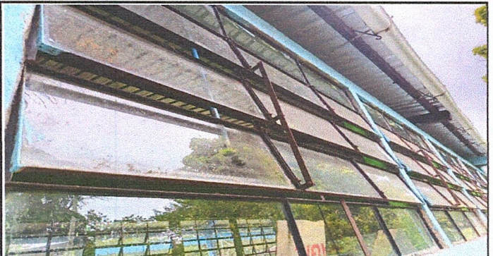
Foto 2: Falta de mantenimiento a las ventanas del centro educativo.
