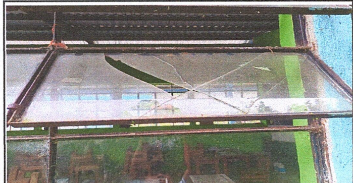
Foto 3: Vidrios quebrados en ventanas del centro educativo.
